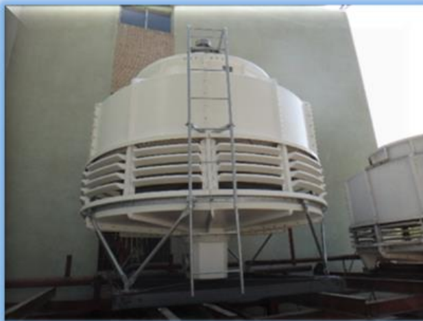
دستگاه برج خنک کن بعد از اجرا
