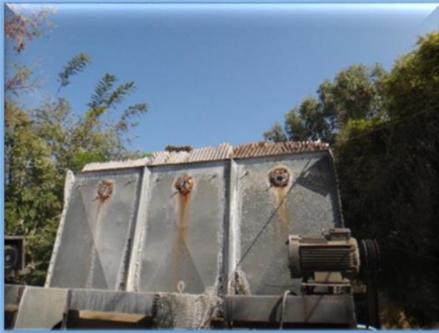
دستگاه برج خنک کن قبل از اجرا
