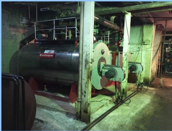
دستگاه دیگ بعد از اجرا
