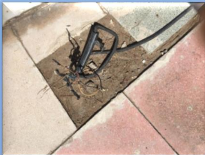
ساماندهی کابل های برق
