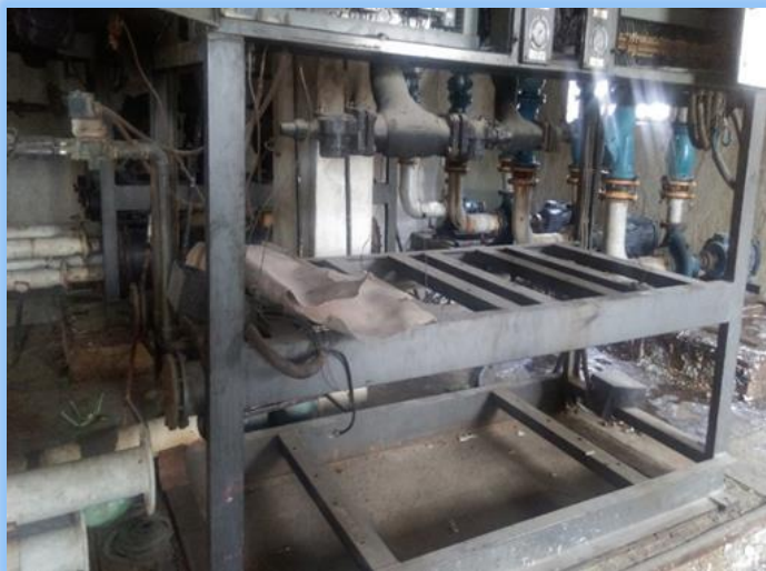
دستگاه چیلر قبل از بازسازی
