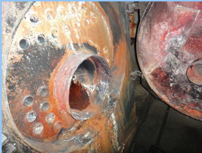
دستگاه دیگ قبل از اجرا
