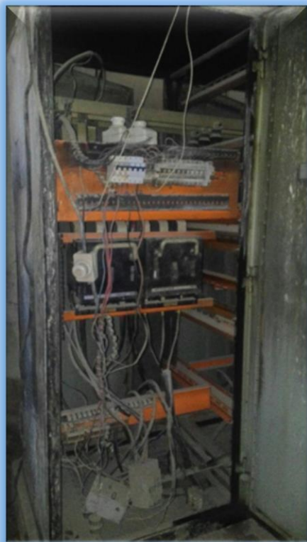
تابلو برق قبل از بازسازی
