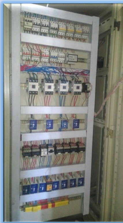
تابلو برق بعد از بازسازی
