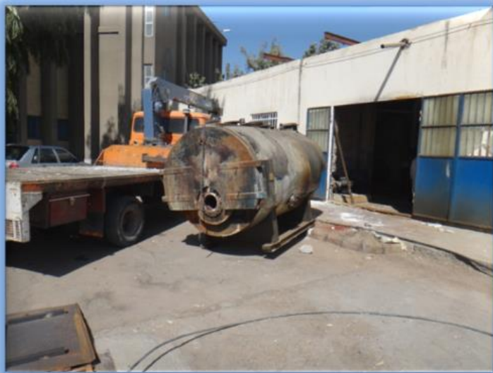
دستگاه دیگ قبل از بازسازی
